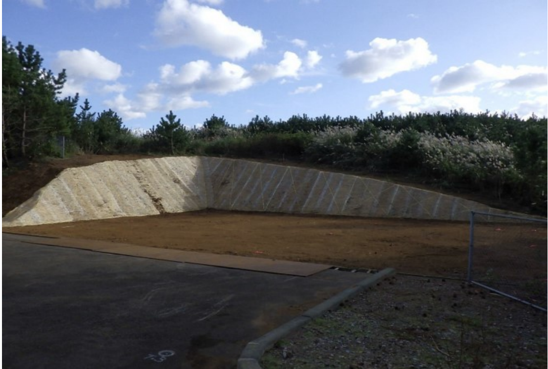
大間配水場内造成・基礎杭工事(令和5年12月竣工) ※令和6年度ステンレス製円形型配水池(500 m 3 )建設予定地
